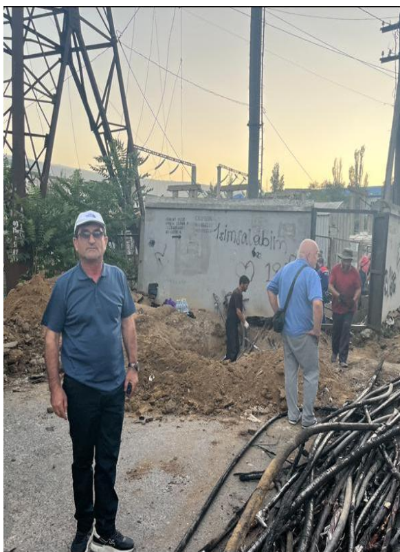
Рис.7. Выездной общественный контроль на подстанции «Новая», г. Махачкала
